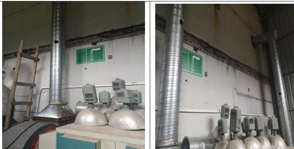
活性炭吸附设备采样口
