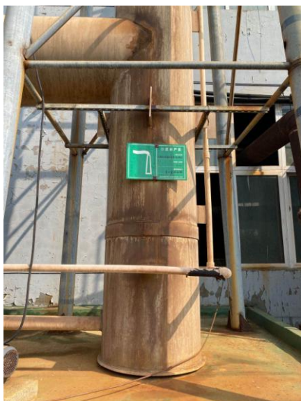
(1) 现有工程排气筒
